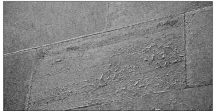
Kuva 3-100. Lumiauran rikkomaa julkisivuverhousta.
