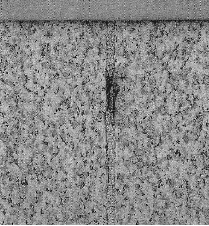
Kuva 3-94. Kivikiinnikkeen ruostumisesta johtuva saumavaurio.
