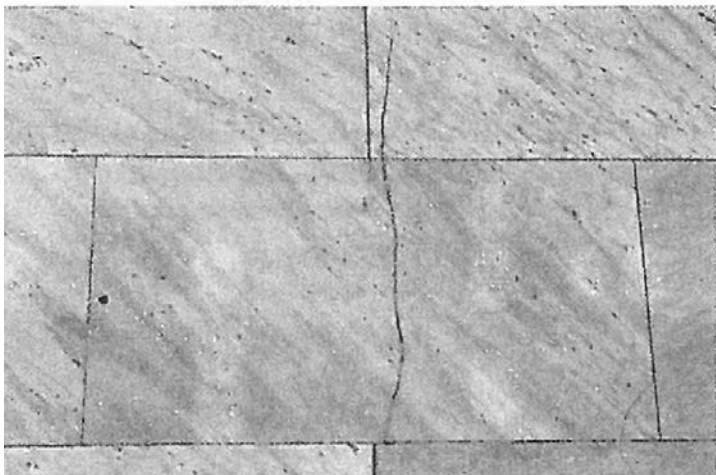
Kuva 4-62. Lattiarakenteen muodonmuutoseroista johtuva halkeama kivilaattapäällysteessä.
